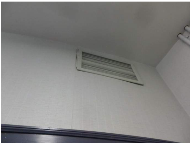
Return air grille
